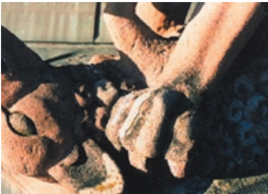
Stark geschädigte Pranke des alten Löwen, mit Antragungen von Steinersatzmasse
